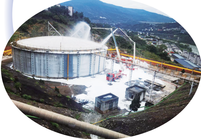
攀枝花消防救援支队处置瓜子坪煤气柜火灾。
