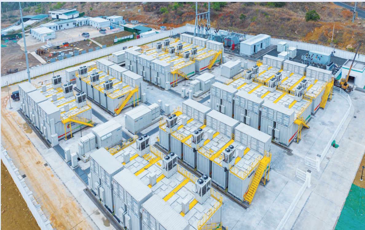
12MW/60MWh全钒液流储能电站储能区。
