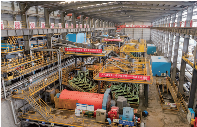
龙佰丰源公司磨矿分级系统技改工程项目正在满负荷运行。
