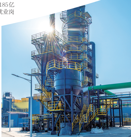
氯化钛渣厂生产现场。
